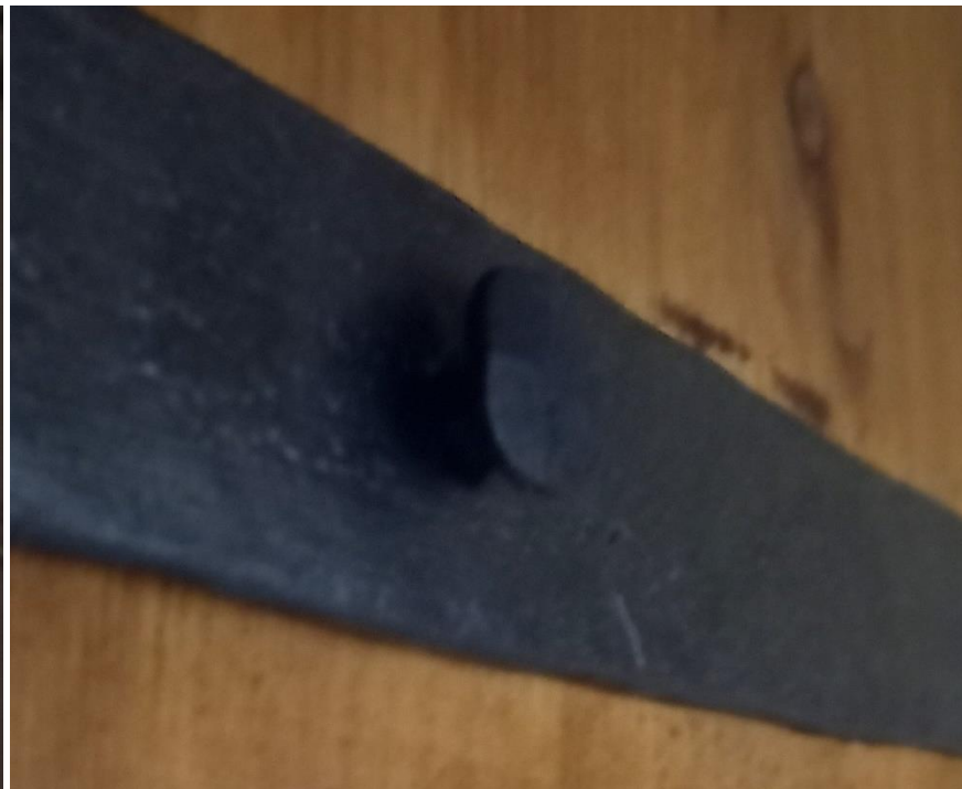
Vypadávající hřeby ze dveří na točité schodiště kúru
