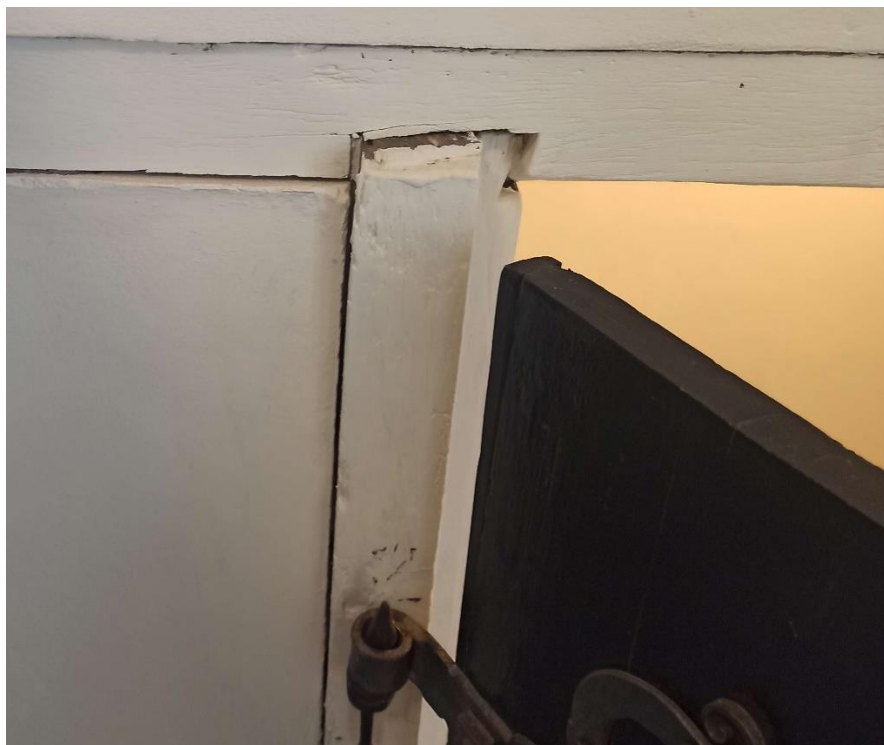
Příloha č.9 – Kotvení sloupku tesařských zárubní dveří ze schodů do oratoře – fotodokumentace
