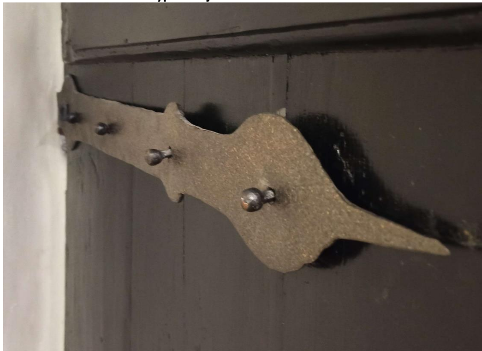
Vylézající hřeby u dveří ze sakristie do presbytáře.
