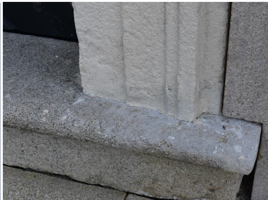
Zbytky malty a fasádního nátěru na restaurovaných kamenných prvcích.
