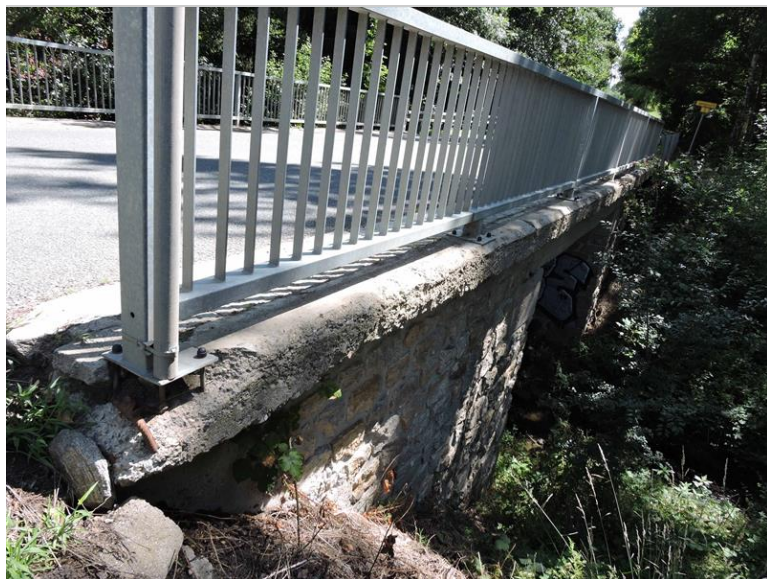
DSCN5421-resize.JPG Celkový pohled PS POS
