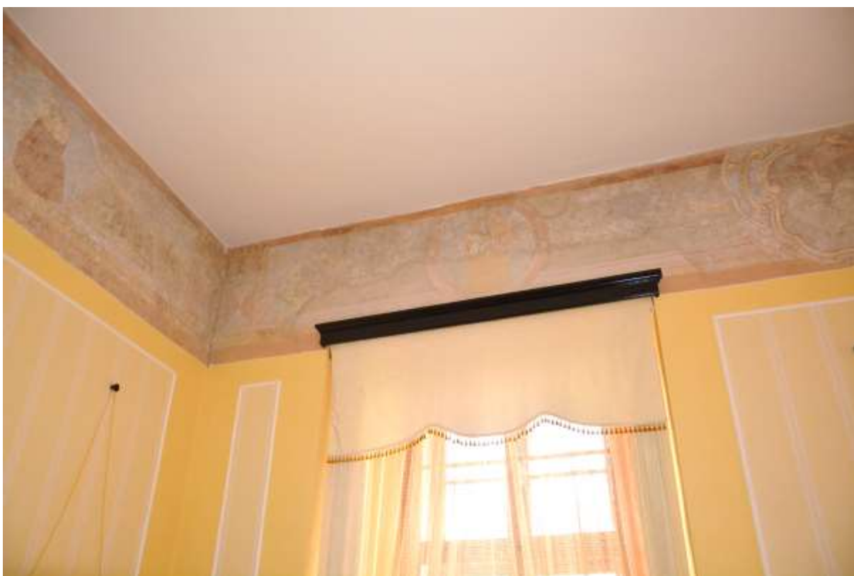
15. Malby pod stropem v Ložnici 2.05.
