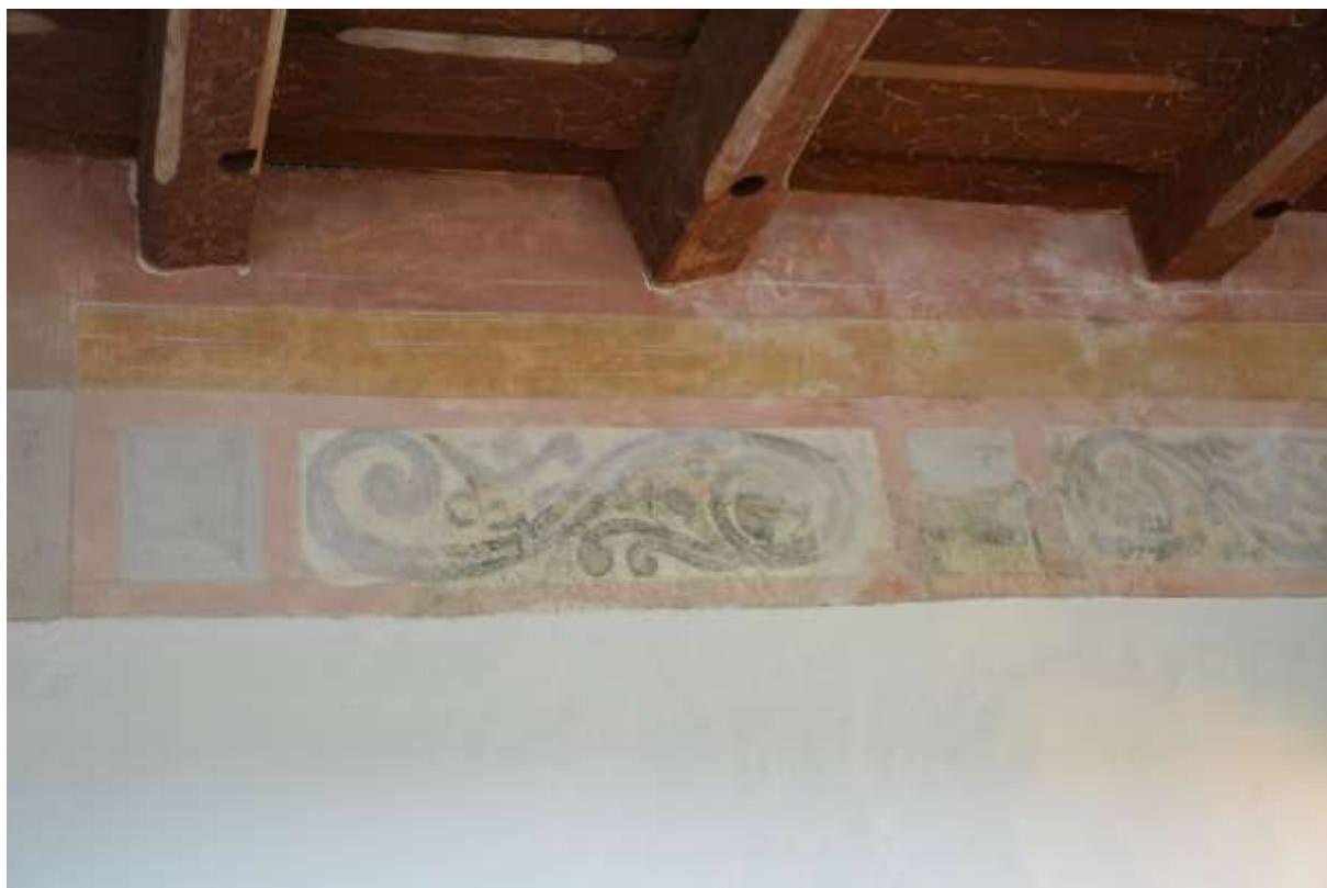
42. Poškozená malba ve Velkém sále 2.10.
