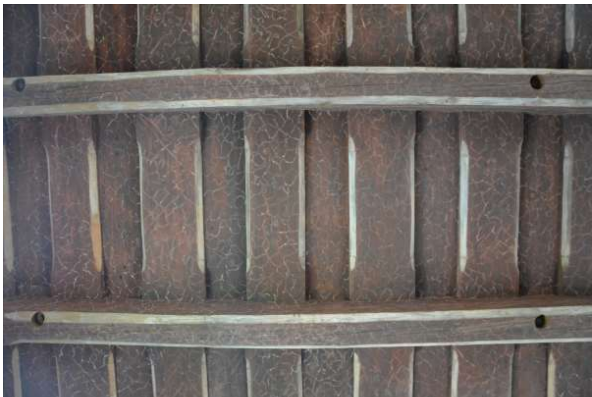
52. Lokální poškození záklopového stropu ve Velkém sále 2.10.
