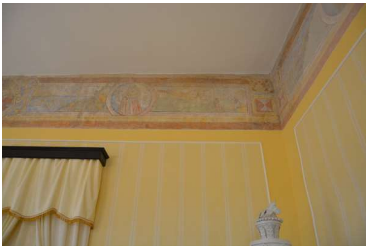
17. Malby pod stropem v Ložnici 2.05.
