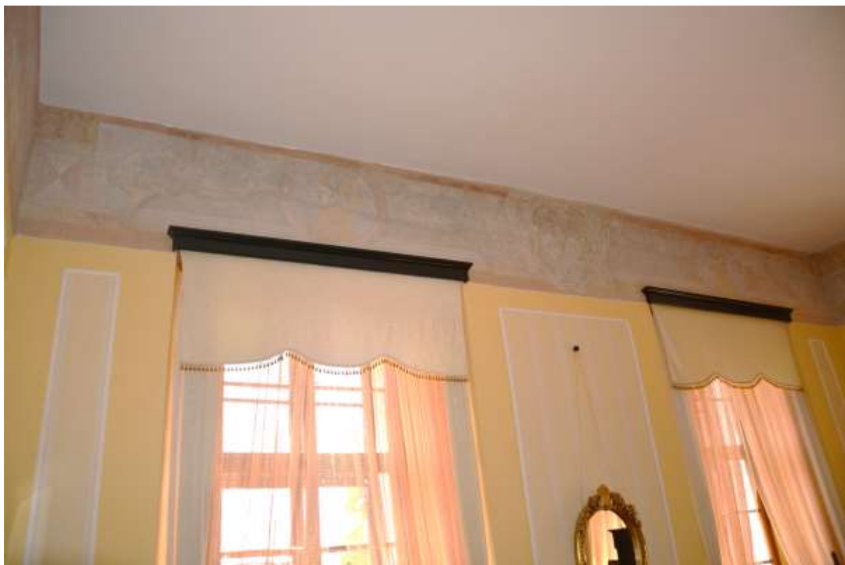
20. Malby pod stropem v Ložnici 2.05 .
