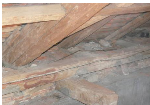
Obr. Příklad zanesení dolní části konstrukce starými stavebními zbytky
