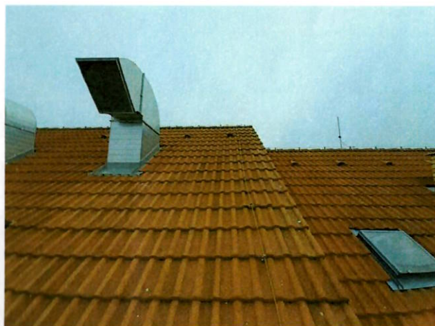
foto/5/ Pohled na střešní krytinu z exteriéru
