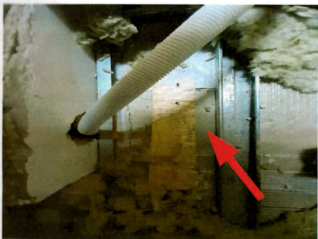
foto/31/ Pohled na chybějící parozábranu
