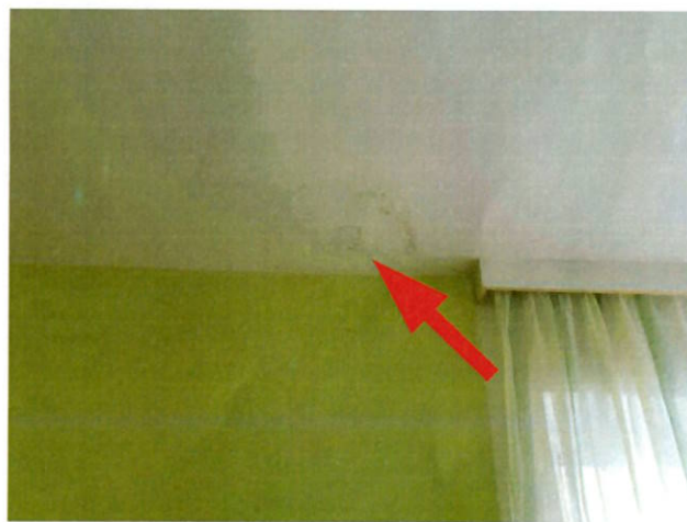
foto/2/ Pohled na stopy zatékajících srážek na stropě jídelny
