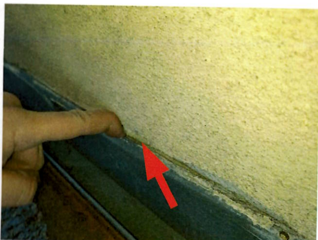
foto/21/ Detail oplechování vikýře a degradované tepelné izolace
