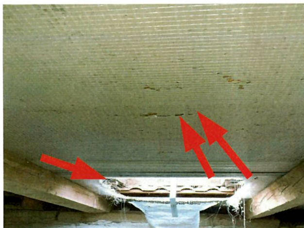
foto/17/ Pohled na degradovanou fólii a opravování otvoru
