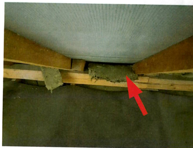
foto/24/ Pohled na vyplněné přívodní otvory vzduchu
