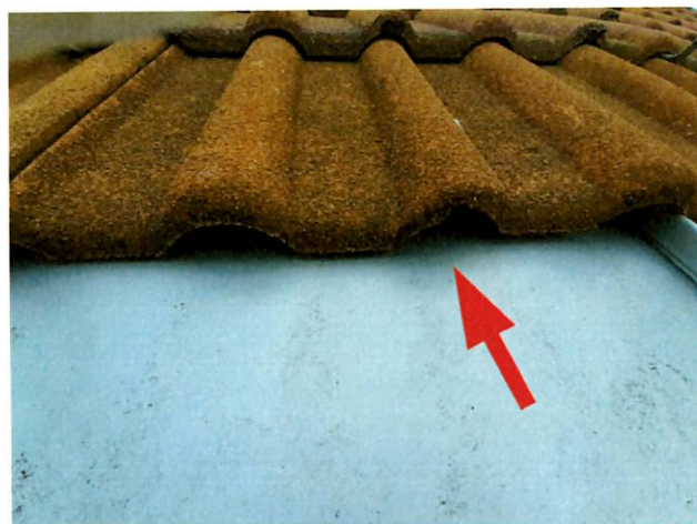
foto/28/ Pohled na přívodní otvory vzduchu v místě napojení střech se skládanou a plechovou krytinou
