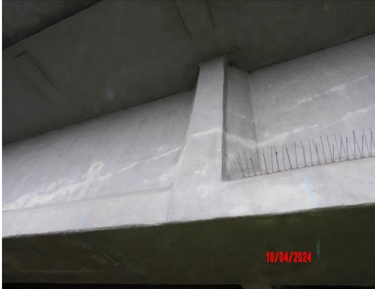
Obr. 3. 6: Levý krajní nosník ve 3. poli z vnější strany – trhliny s výluhy kopírující průběh předpínacích lan – typická porucha pro dva levé krajní nosníky.
