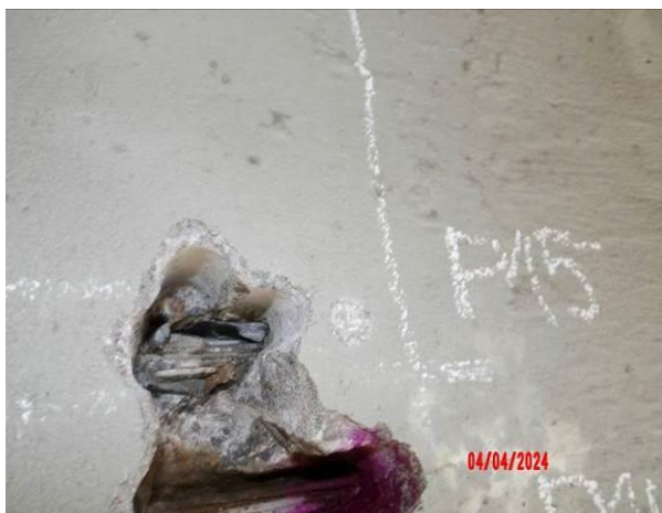
Obr. 3. 59: Sonda provedena na spodní části 2. příčnicku mezi nosníky N1 a N2 v poli 2. Místo s výluhy. Předpínací dráty v ocelové chráničce. Chránička bez koroze.
