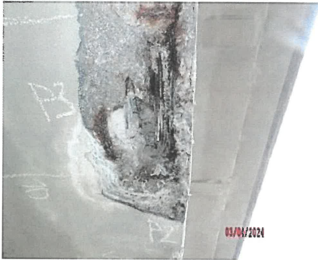
Obr. 3. 17: Sonda provedena na spodním lici nosníku N1 v poli 1 přibližně v polovině délky v s odseparovaným krytím. Předpínací dráty původně v ocelové chráničce. Ta je nyní zcela strávena korozí.
