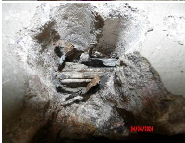
Obr. 3. 60: Detail po otevření kanálku – kabel částečně zainjektovaný, injektát se jevil suchý. Předpínací dráty s korozi zhrublým povrchem. Krytí po dráty cca 50 mm.
