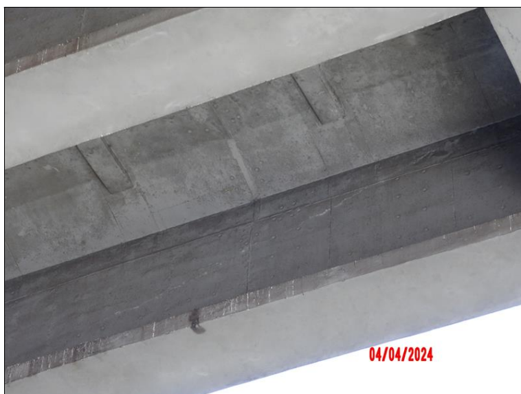
Pravý krajní trám ve 3. poli - trhliny kopírující průběh předpětí
