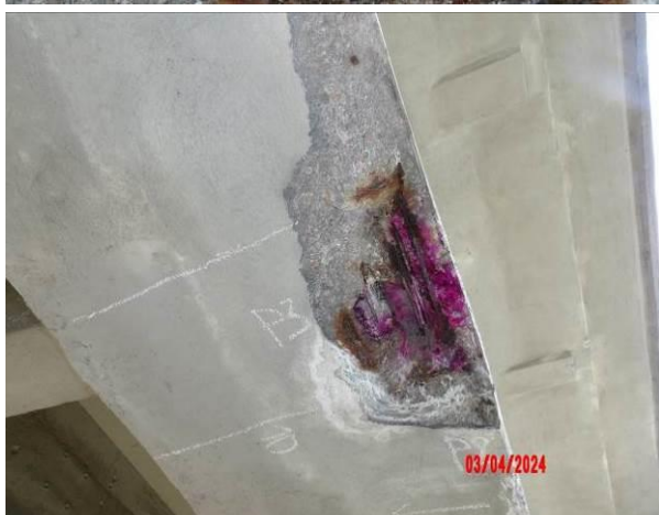
Obr. 3. 25: Detail po zkoušce karbonatace roztokem fenolftaleinu – karbonatace betonu cca 20 mm.
