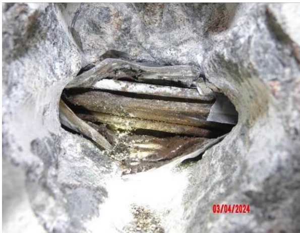
Obr. 3. 30: Detail po otevření kanálku – kabel nezainjektovaný, v chráničce mokro. Dráty s korozí zhrublým povrchem. Krytí po dráty cca 70 mm.
