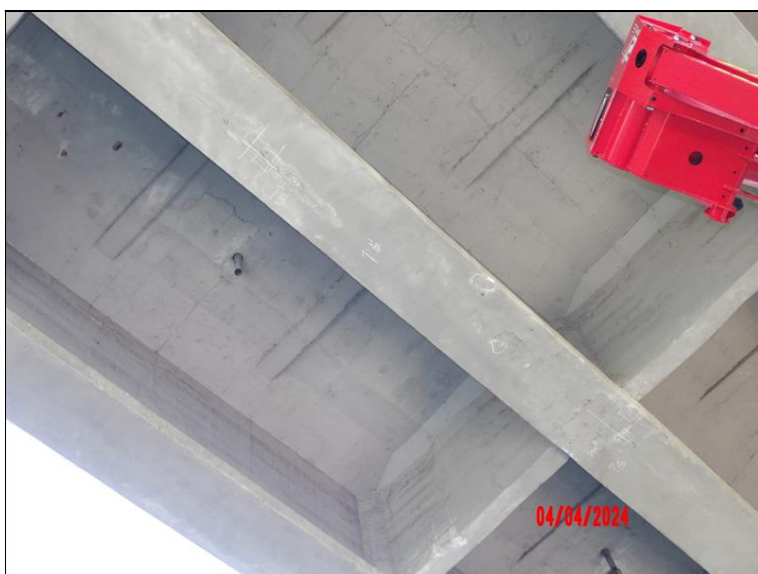
Podhled NK ve 2. poli - 2. trám zleva. Na podhledu trámu trhliny kopírující průběh předpětí.
