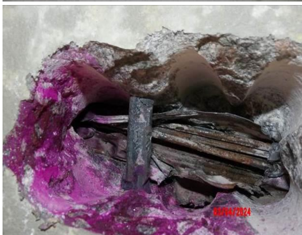
Obr. 3. 36: Detail po otevření kanálku – kabel nezainjektovaný, dráty mokré a při zkoušce páčením se jevíly volné. Dráty s korozí zhrublým povrchem. Krytí po dráty cca 80 mm.
