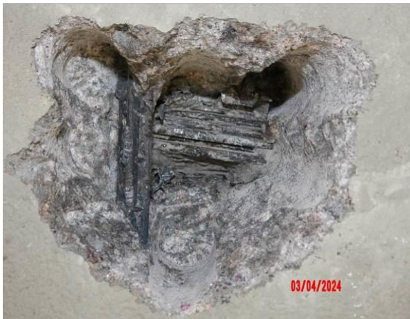
Obr. 3. 33: Detail po otevření kanálku – kabel plně zainjektovaný, injektát však mokrý. Dráty s povrchovou korozí. Krytí po dráty cca 75 mm.
