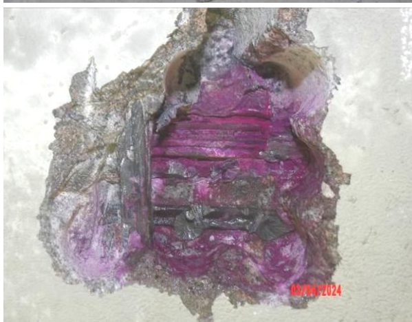
Obr. 3. 28: Detail po zkoušce karbonatce roztokem fenolftaleinu – karbonatace betonu cca 0-5 mm.
