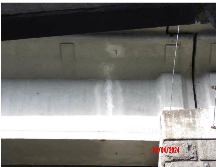
Obr. 3. 8: Levý krajní nosník ve 3. poli – průsaky s výluhy – lokální porucha
