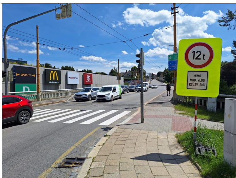
Most po směru staničení - dopravní značení, které zamezuje vjezd na most vozidlům s hmotností větší než 12 t.
