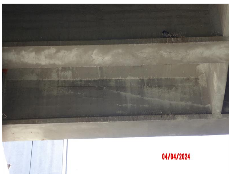
Levý krajní trám v poli 3 poblíž P3. Trhliny kopírující průběh předpětí.
