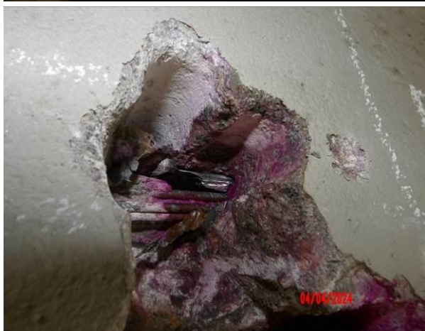
Obr. 3. 61: Detail po zkoušce karbonatce roztokem fenolftaleinu – karbonatce betonu <5 mm.
