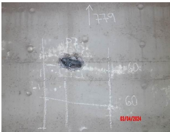
Obr. 3. 35: Sonda provedena ve stojně nosníku N1 v poli 1 ve druhé pětině jeho délky v místě výluhů. Předpínací dráty v ocelové chráničce. Chránička lokálně s povrchovou korozí.
