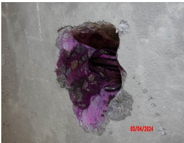
Obr. 3. 31: Detail po zkoušce karbonatce roztokem fenolftaleinu – karbonatce betonu 0 mm.
