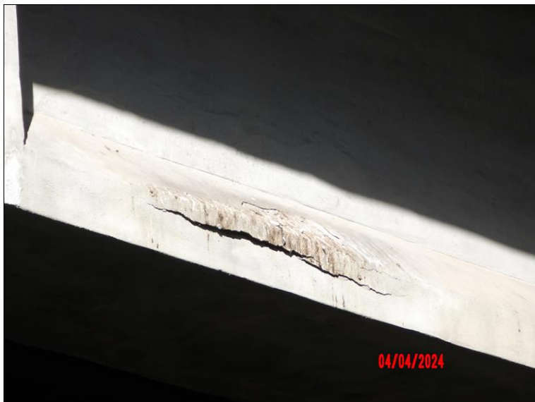
Dolní příruba levého krajního nosníku v poli 2. Po odstranění krycí vrstvy zde zjištěna silná korozí předpínací výztuže.
