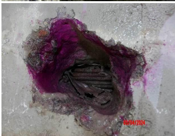
Obr. 3. 19: Detail po zkoušce karbonatace roztokem fenolftaleinu – karbonatce betonu 0 mm.
