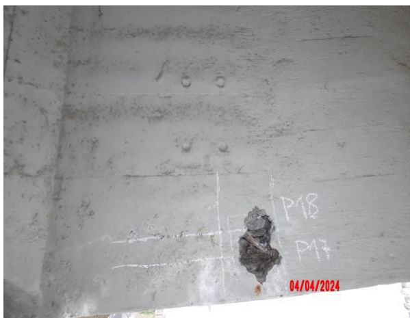
Obr. 3. 65: Sonda provedena na spodní části 3. příčnicku mezi nosníky N1 a N2 v poli 2. Místo s výluhy. Předpínací dráty původně v ocelové chráničce. Chránička již zcela strávená korozí.
