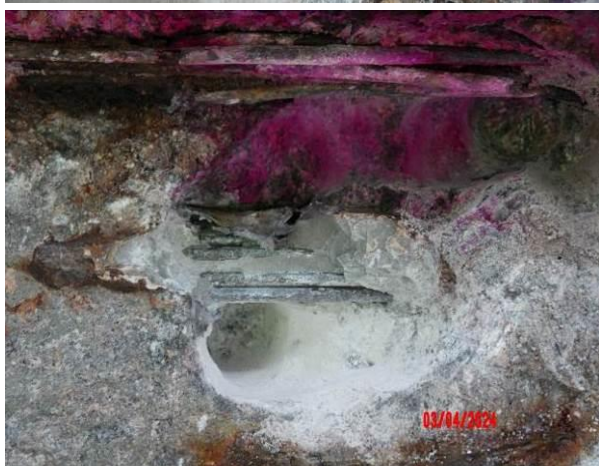
Obr. 3. 24: Detail po otevření kanálku – kabel zainjektovaný, v místě sondy však injektát vypadaný. Dráty s povrchovou korozí bez úbytku. Krytí po dráty cca 35 mm.
