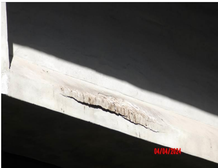
Obr. 3. 7: Levý krajní nosník ve 2. poli – samovolně odseparované krytí, lokální porucha.
