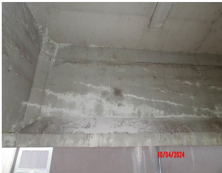
Obr. 3. 3: Levý krajní nosník ve 3. poli – trhliny s výluhy kopírující průběh předpínacích lan – typická porucha pro dva levé krajní nosníky.
