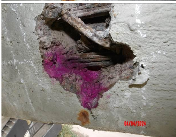
Obr. 3. 67: Detail po zkoušce karbonatace roztokem fenolftaleinu – z důvodu mokrého povrchu nebylo možné odstranit prach – zkouška neprovedena.
