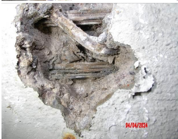
Obr. 3. 66: Detail po otevření kanálku – kabel nezainjektovaný. Předpínací dráty silně korodované – úbytek lokálně <50 %. Krytí po dráty cca 50 mm.
