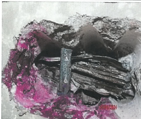
Obr. 3. 33: Detail po otevření kanálku – kabel nezainjektovaný, dráty mokré a při zkoušce páčením se jevíly volné. Dráty s korozí zhrublým povrchem. Krytí po dráty cca 80 mm.
