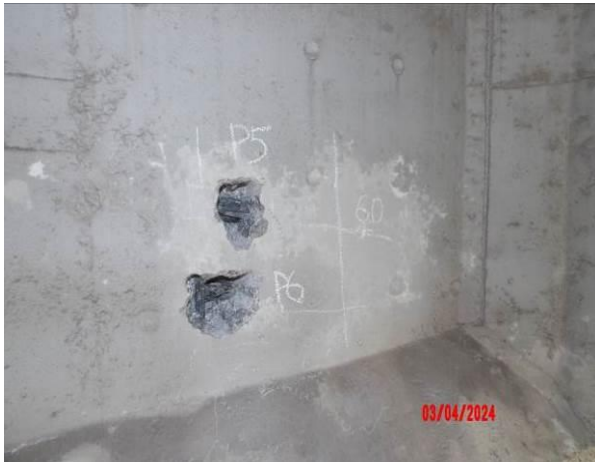
Obr. 3. 32: Sonda provedena ve stojně nosníku N1 v poli 1 ve druhé pětině jeho délky v místě výluhů. Předpínací dráty v ocelové chráničce. Chránička lokálně s povrchovou korozí.
