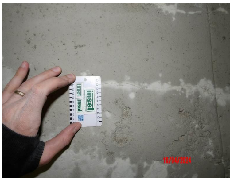
Obr. 3. 4: Levý krajní nosník ve 3. poli – trhliny s výluhy kopírující průběh předpínacích lan – detail.
