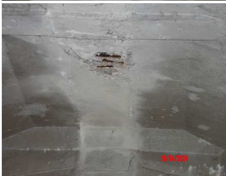
Obr. 3. 5: Odpadlá krycí vrstva v místě dobetonávky mezi nosníky a korodující betonářská výztuž – lokální porucha.
