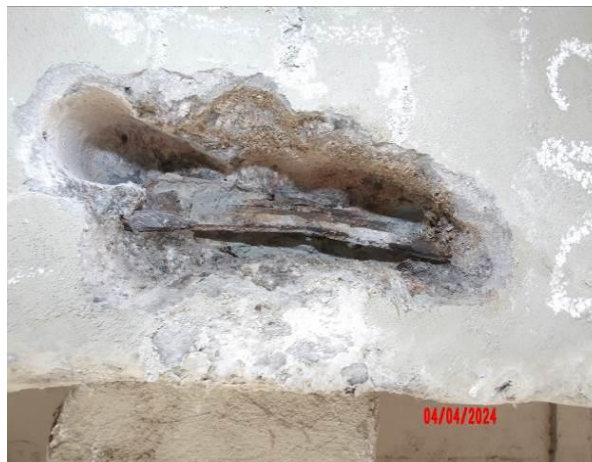
Obr. 3. 88: Sonda provedena na spodním líci nosníku N2 pod třetím příčným v rámci sondy k předpínací výztuži P12. Sondou odhalen prut podélné betonářské výztuže typu ROXOR průměru 10 mm, krytí 5 mm. Korozí zhrublý povrch, karbonatace betonu 0 mm.
