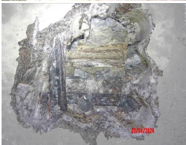
Obr. 3. 27: Detail po otevření kanálku – kabel plně zainjektovaný, injektát však vlhký. Dráty s povrchovou korozí bez úbytku. Krytí po dráty cca 45 mm.
