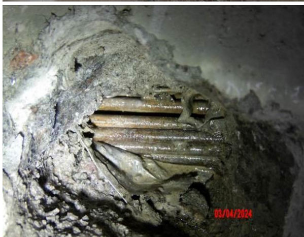
Obr. 3. 18: Detail po otevření kanálku – kabel nezainjektovaný, plný vody – po otevření chráničky vytekla voda. Předpínací dráty s hrubým povrchem, při zkoušce páčením se dráty jevíly volné. Krytí po dráty cca 75 mm.
