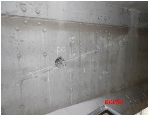
Obr. 3. 41: Sonda provedena na pravém boku stojiny nosníku N1 v poli 1 v páté pětině jeho délky v místě trhliny s výluhy. Předpínací dráty v ocelové chráničce. Chránička lokálně s povrchovou korozí.
