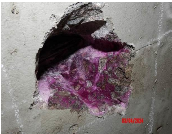
Obr. 3. 43: Detail po zkoušce karbonatce roztokem fenolftaleinu – karbonatce betonu 0 mm.
