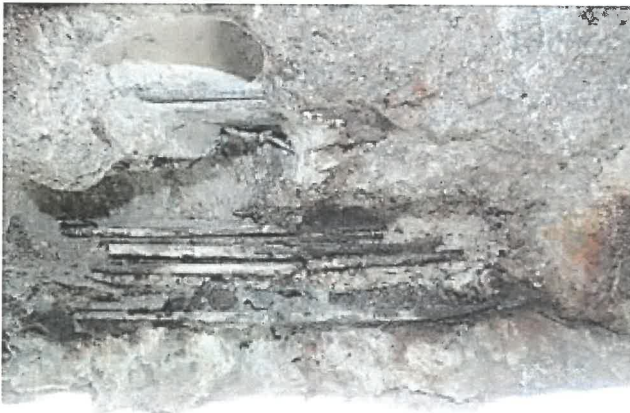
Obr. 3. 18: Detail po otevření kanálku – kabel zainjektovaný, v místě sondy však injektát vypadaný. V sondě minimálně 5 drátů přerušených korozí, zbytek s úbytkem 30 %. Krytí po dráty cca 30 mm.
