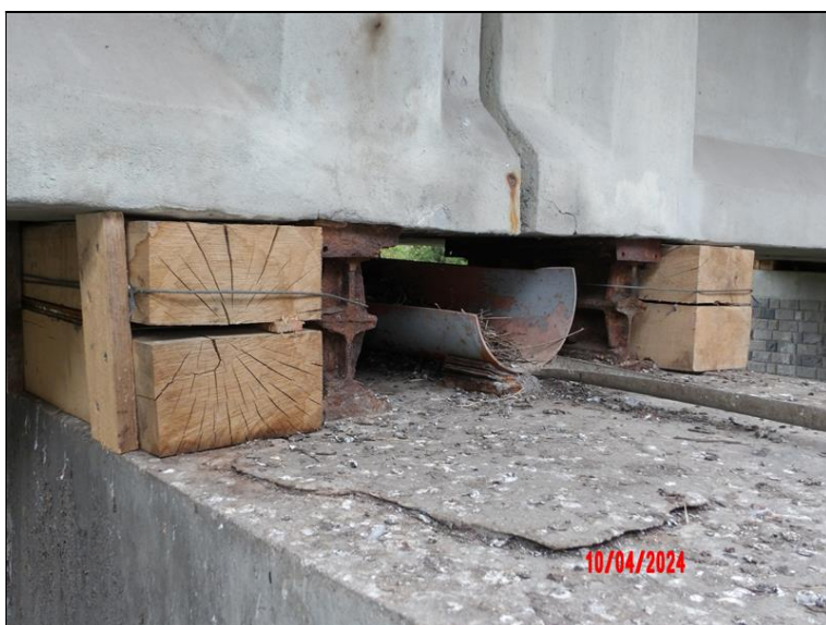
Provizorně podepřená ložiska na pilíři P2 vlevo
