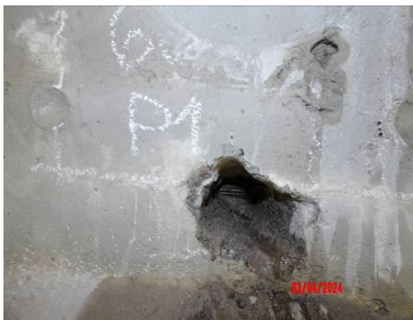
Obr. 3. 17: Sonda provedena ve stojně nosníku N1 v poli 1 přibližně v polovině délky v místě s výluhy zvýrazněnou trhlinou kopírující průběh kabelu. Předpínací dráty v ocelové chráničce.
