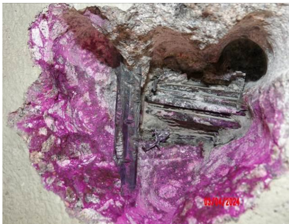
Obr. 3. 87: Sonda provedena na nosníku N1 v poli 1 mezi nosníky N1 a N2 ve skvrně výluhů v rámci sondy k předpínací výztuži P6. Sondou odhalena svislá betonářská výztuž nosníku. Výztuž typu ROXOR průměru 16 mm, krytí 45 mm, bez koroze, karbonatace betonu 0 mm.
