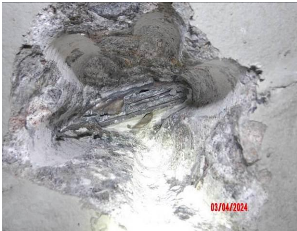
Obr. 3. 42: Detail po otevření kanálku – kabel částečně zainjektovaný, injektát se jevil suchý. Dráty s povrchovou korozí, bez úbytku. Krytí po dráty cca 85 mm.
