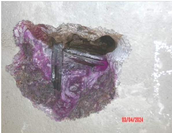
Obr. 3. 34: Detail po zkoušce karbonatce roztokem fenolftaleinu – karbonatce betonu 0 mm.
