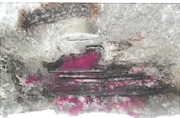
Obr. 3. 19: Detail po zkoušce karbonatace roztokem fenolftaleinu – karbonatace betonu cca 20 mm.
