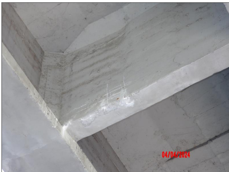
3. příčník v poli 2 u levého krajního trámu. Po odstranění krycí vrstvy zjištěna korozí příčné předpínací výztuže.
