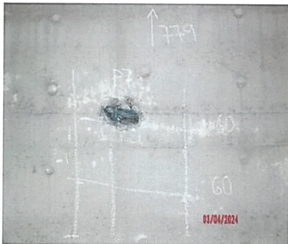
Obr. 3. 32: Sonda provedena ve stojině nosníku N1 v poli 1 ve druhé pětíně jeho délky v místě výluhů. Předpínací dráty v ocelové chráničce. Chránička lokálně s povrchovou korozí.
