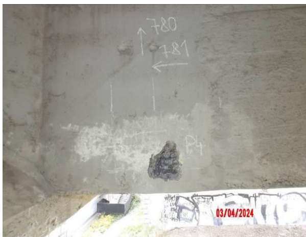
Obr. 3. 26: Sonda provedena na spodní části stěny 3. příčnicku mezi nosníky N1 a N2. Místo s výluhy na povrchu. Předpínací dráty v ocelové chrániče bez koroze.
