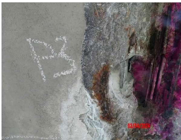
Obr. 3. 23: Sonda provedena na spodním líci nosníku N1 v poli 1 přibližně v polovině délky v s odseparovaným krytím. Předpínací dráty v ocelové chrániče s povrchovou korozí.
